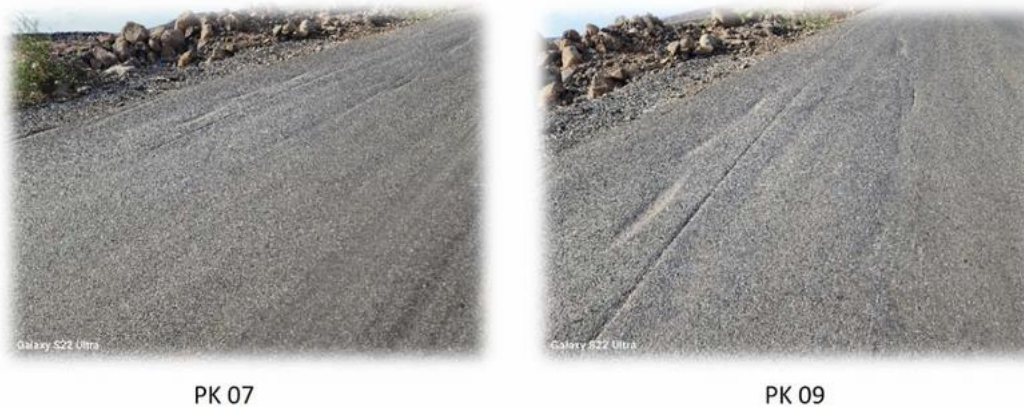
Figure 4 : photo sur l'état de la route prise à différent endroit
