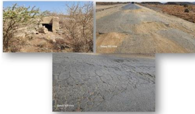
Figure 5: État des ouvrages et du chaussée du tronçon faisant l'objet de l'étude (source auteur de l'étude)
